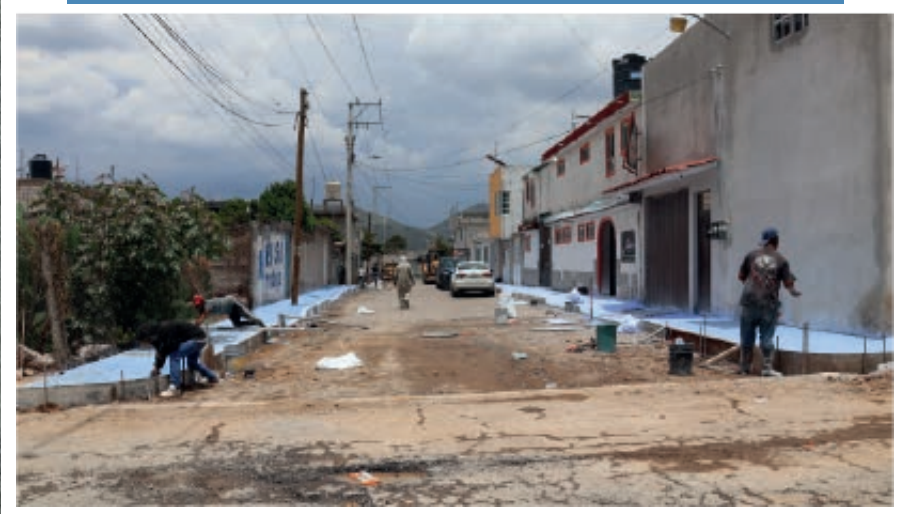
➤ Construcción de pavimentación de la Calle Alhelí en la Colonia Buenos Aires
